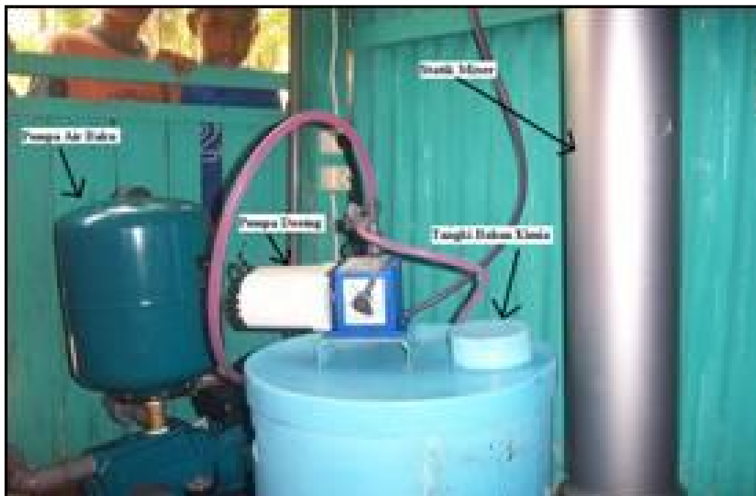
Foto 4 : Pompa air baku, pompa dosing, tangki bahan kimia dan statik mixer.
