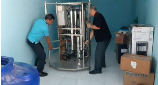
a) Instalasi Ultra Dan Ro Filtrasi
