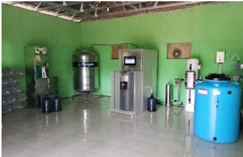
Gambar 6. Unit Pengolahan Arsinum yang terpasang di Pesantren Subbanul Yaum
