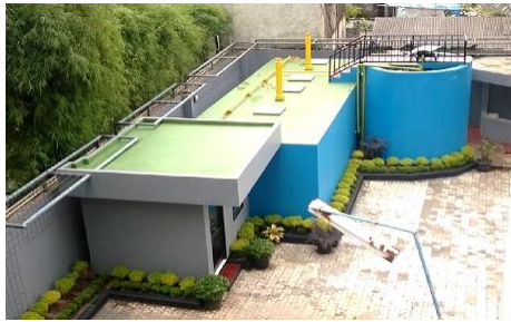
Gambar 1. Instalasi Pengolahan Air Limbah BPPT
