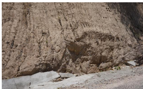
Gambar 10. Bahaya Tanah Longsor Akibat Pemotongan Lereng yang Terjal di Sepanjang Jalan di Pulau Banggai
