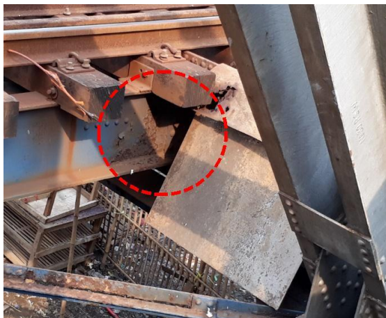
Gambar 4. Korosi pada Web dan Flange pada Plate Girder Tengah (Jembatan KA 2a)
