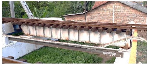
Gambar 5. Jembatan KA 2b Berupa 2 (dua) Bentang Jembatan Plate Girder Beam Bentang 8m
