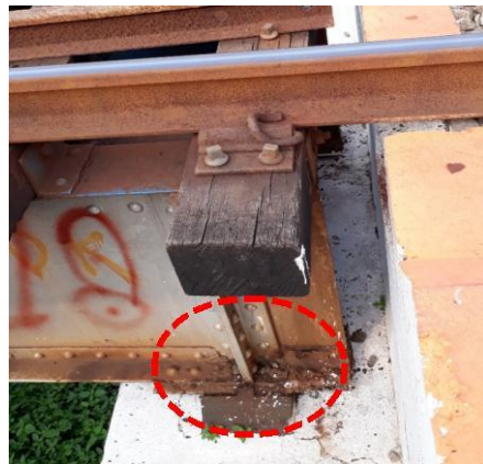
Gambar 6. Korosi pada Flange Tumpuan Jembatan Plate Girder Baja (Jembatan KA 2b)
