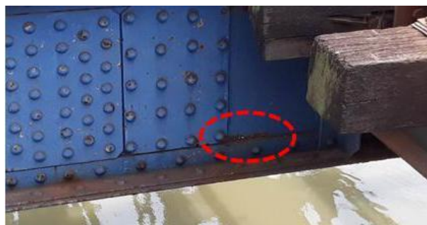
Gambar 2. Korosi yang Telah Terjadi pada Web Plate pada Plate Girder Balok Melintang pada Jembatan KA 1
