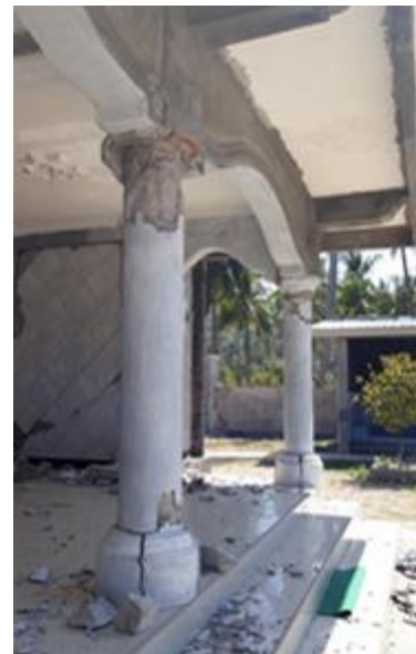
Gambar 4. Pola Kerusakan yang Terjadi pada Bangunan adalah Rusaknya Kolom-Kolom
