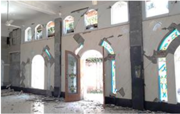
Gambar 5. Deformasi yang Besar Saat Terjadi Gempa Menyebabkan Kerusakan pada Komponen Non Struktural yang Dapat Membahayakan
