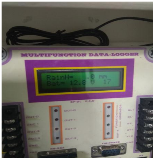
Gambar 5. Pengecekan Pengukuran Awal Sensor Curah Hujan dan Daya
