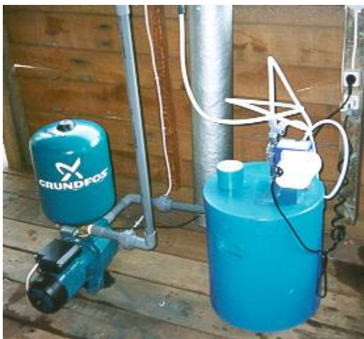
Gambar 17 : Pompa air baku dan sistem injeksi larutan soda ash ( \text{NaHCO}_3 ) untuk menaikkan pH air.
