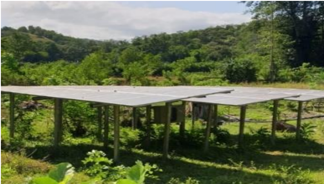
Gambar 5. Solar panel yang ada di desa Warloka (Sumber: Dokumentasi Penulis, 2021)
