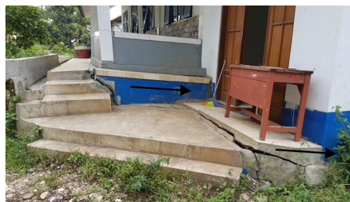
Gambar 4. Rekahannya bangunan di kompleks madrasah di Balekambang. Tanda panah menunjukkan arah gerakan yaitu ke arah barat laut.
