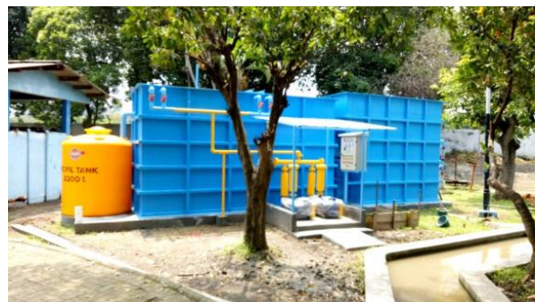
Gambar 2. Unit Pilot Plant Biofilter yang Sudah Terpasang.
