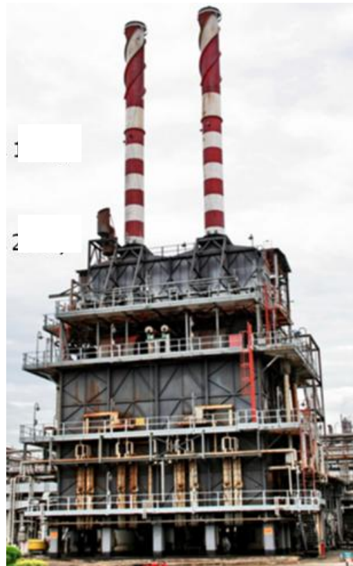
Gambar 1. Foto Unit Heater di salah satu kilang pengolahan
